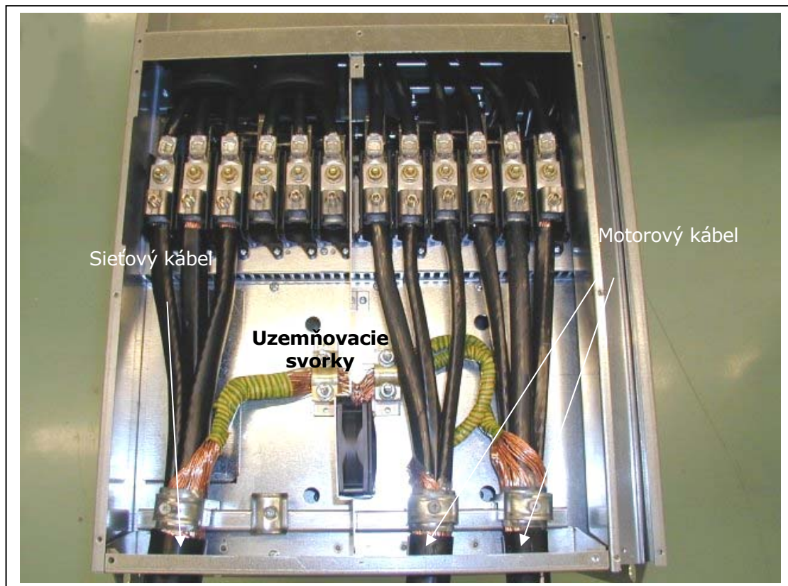
Obr. 6-19. Inštalácia káblov Vacon NX, FR9
